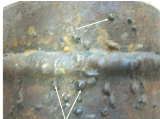
рис.5 - видимый дефект в виде затвердевших капель расплавленного металла Устранение производится срубанием застывших капель или шлифовкой специальными инструментами. [2, с.187]
